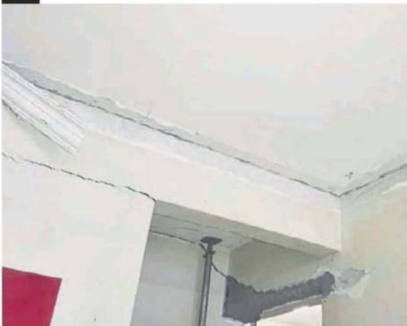
■屋墙龟裂，基于安全问题，住户已迁离。
