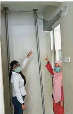
拖了兩年多未維修的房屋，承包商為防屋子結構不穩，使用鋼管支撐屋頂，左起王詩棋及顏麗麗。
